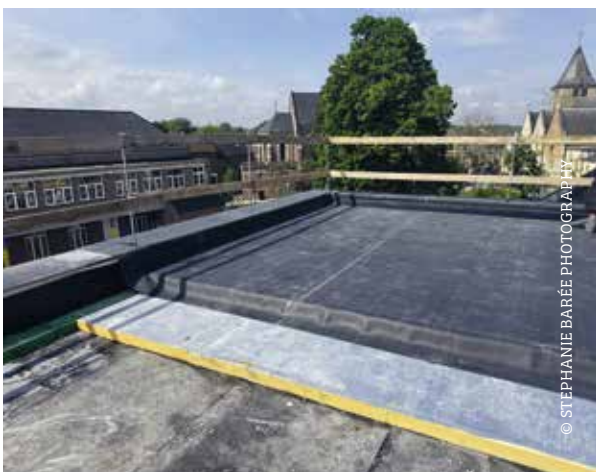
VBS de Bron in Wellen: losliggende EPDM bovenop isolatie
